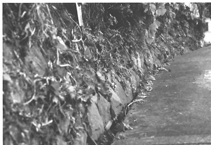
写真 5 斜面崩壊前 昭和61年12月 6 日
