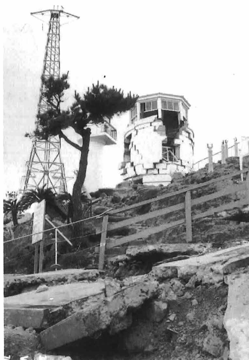
写真2・2・11 1974(昭和49)年 伊豆半島沖地震で崩れた伊廊崎燈台(1974年5月)
