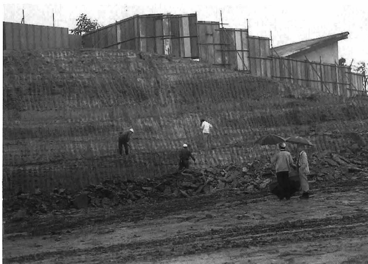
写真1 宅地造成工事により露出した酸性泥岩（川崎市麻生区上麻生）
