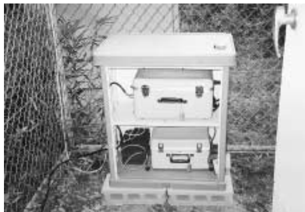
写真 1 - 1 野外設置補助記録装置 1996(平成 8)年 9 月 19 日 駒ヶ岳観測施設
