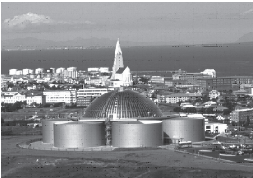
写真5 高台に設置された温水タンク (環境省, 2011 より)
