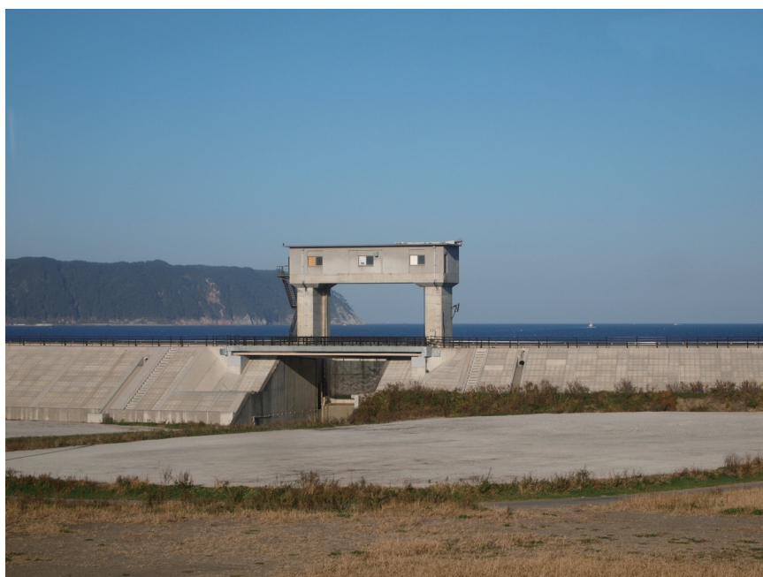
写真10 三陸鉄道の車内から見える防潮堤。水門右上の屋根が、津波により破壊されている。
