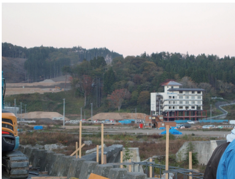
写真 12 田老観光ホテル（写真右奥）。1、2 階部分が流され、鉄骨がむき出しになっている。
