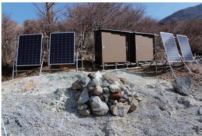
写真 9 大涌谷に設置した多項目火山性ガス成分観測システム（2016 年 2 月 19 日撮影）。
