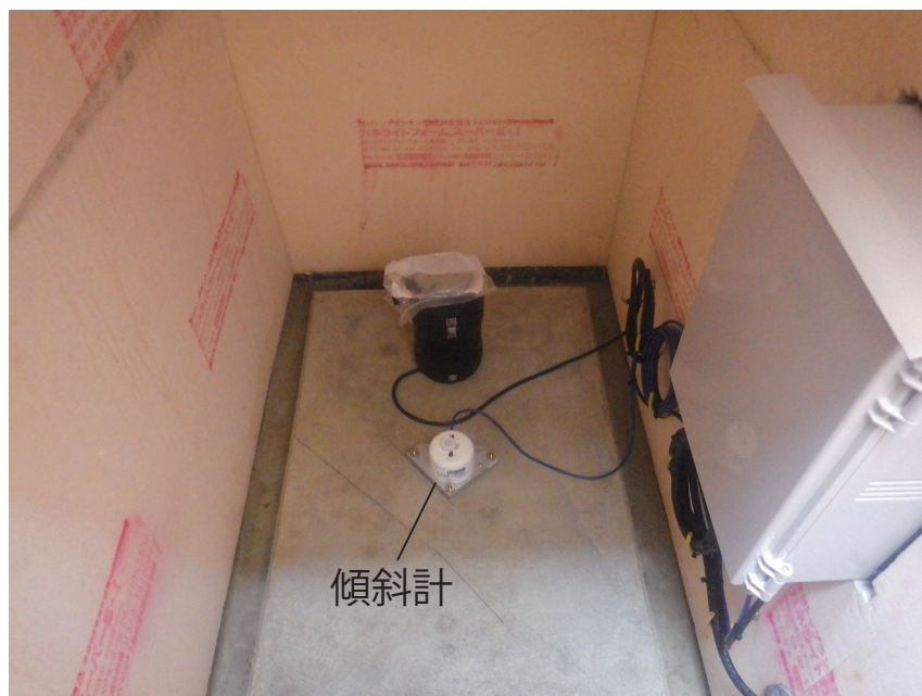
写真 3 下湯場観測点観測坑内に設置されたバブル式傾斜計。
