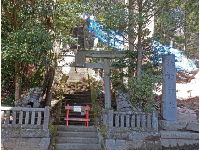
写真4 諏訪神社。2019（令和元）年の台風19号の被害により、2020（令和2）年3月10日時点では立ち入り禁止となっています。
