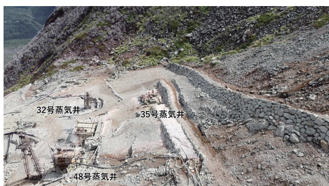
写真 21 35号蒸気井は造成塔ではなく、横置きのタンクで温泉を造成しているので、形がほかの蒸気井とは異なります。ここまで来ると火山ガスの影響も少なくなり、植生の緑が見られるようになりました。
