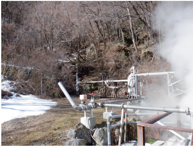
写真 16 早雲山温泉の蒸気井。画面中央やや左側の奥に見えているのが蒸気井です。その他は付随する施設の一部です。
