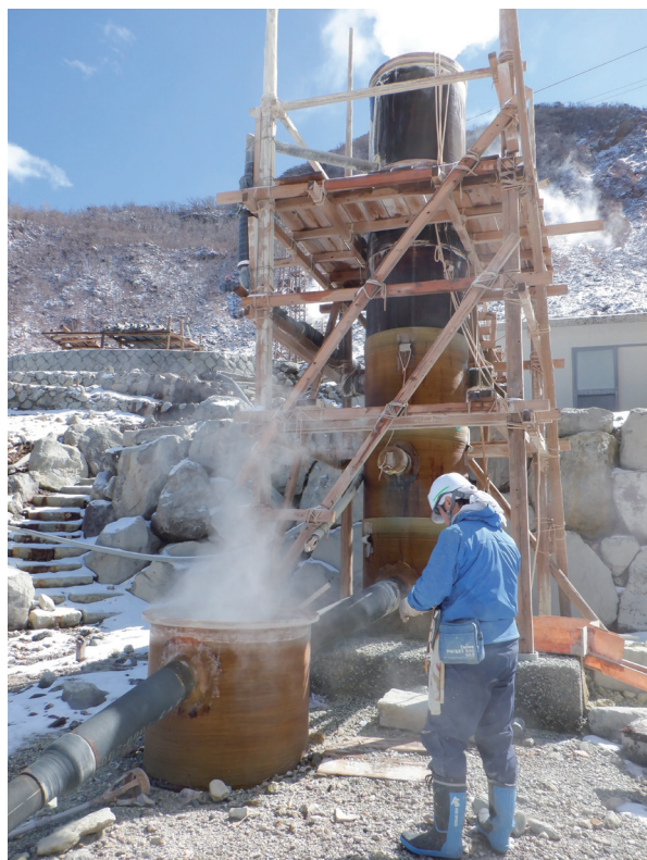
写真 12 大涌谷温泉の縦置き（塔型）の温泉造成装置。塔の下から出てくる蒸気に上から水をかけて温泉を造成しています。左手前の丸い枡にはできあがった温泉水が入っており、配管をとおして運ばれていきます。
