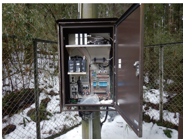
写真3 元箱根観測点のキュービクル内の様子
