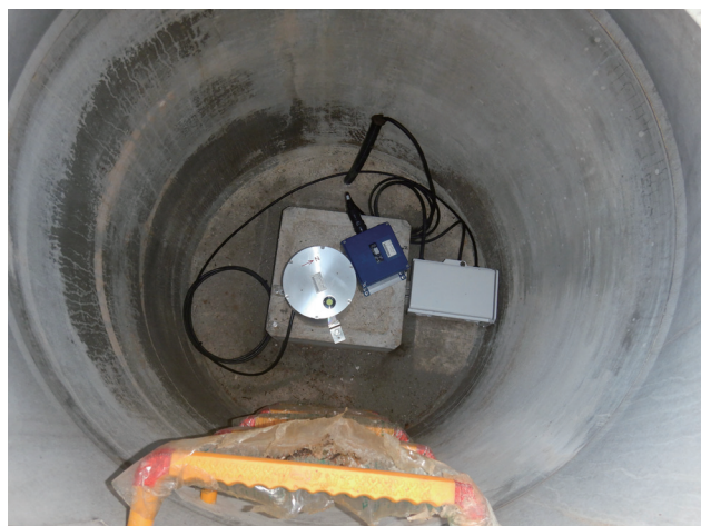
写真5 湯河原観測点の地下ピット内の様子
